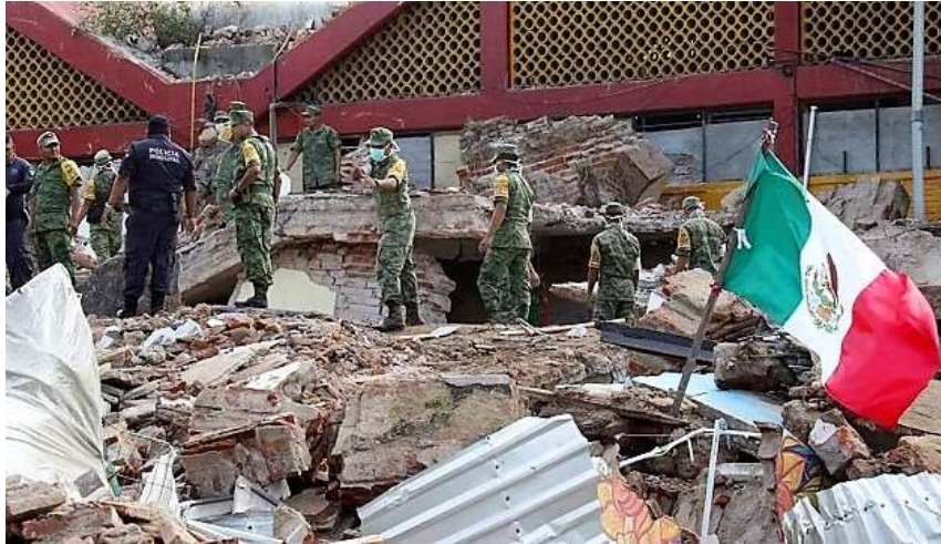
Trabajos en Oaxaca tras el temblor. / AP
